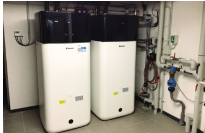
Centrale termica a pompa di calore con integrazione solare termico e alimentazione da fotovoltaico
