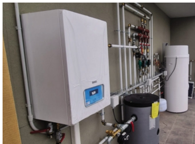
Centrale termica a pompa di calore
