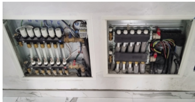
Collettori di alimentazione pannelli radianti e fan coil
