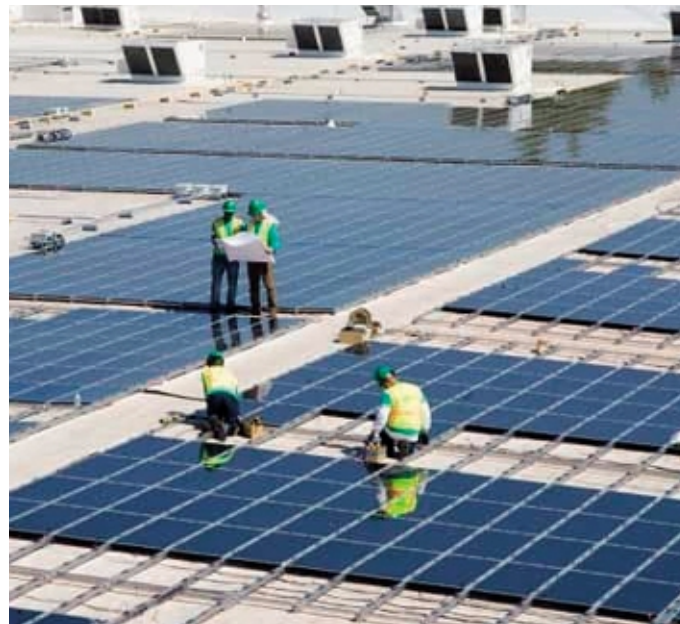
I pannelli fotovoltaici
